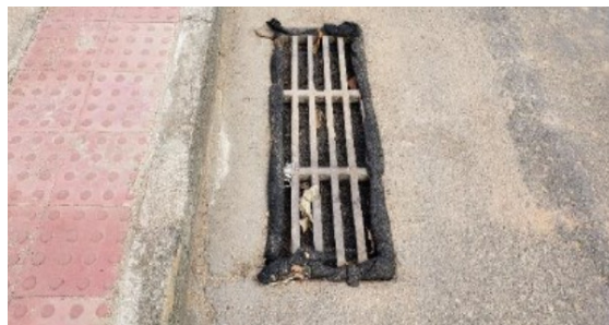
Figura 14: Caixa-ralo com manta geotêxtil para evitar entrada de resíduos
