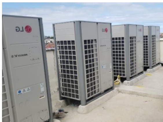
Figura 22: Condensadoras do sistema de ar-condicionado
