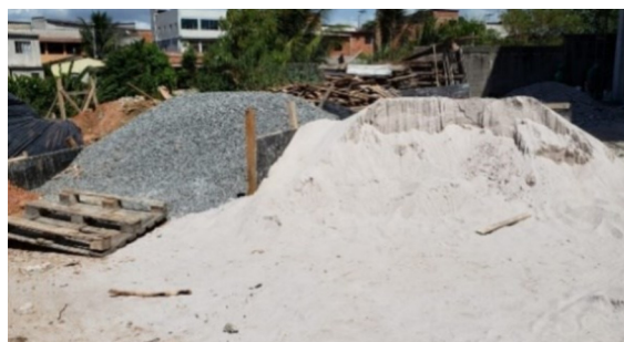
Figura 16: Baias de areia e brita
