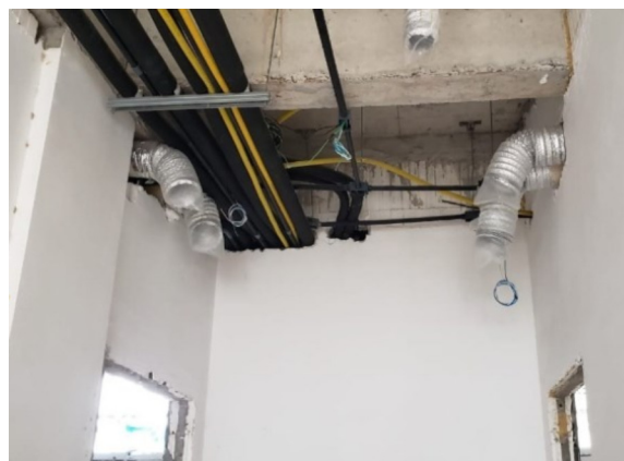
Figura 23: Tubulação de renovação de ar protegida contra entrada de resíduos
