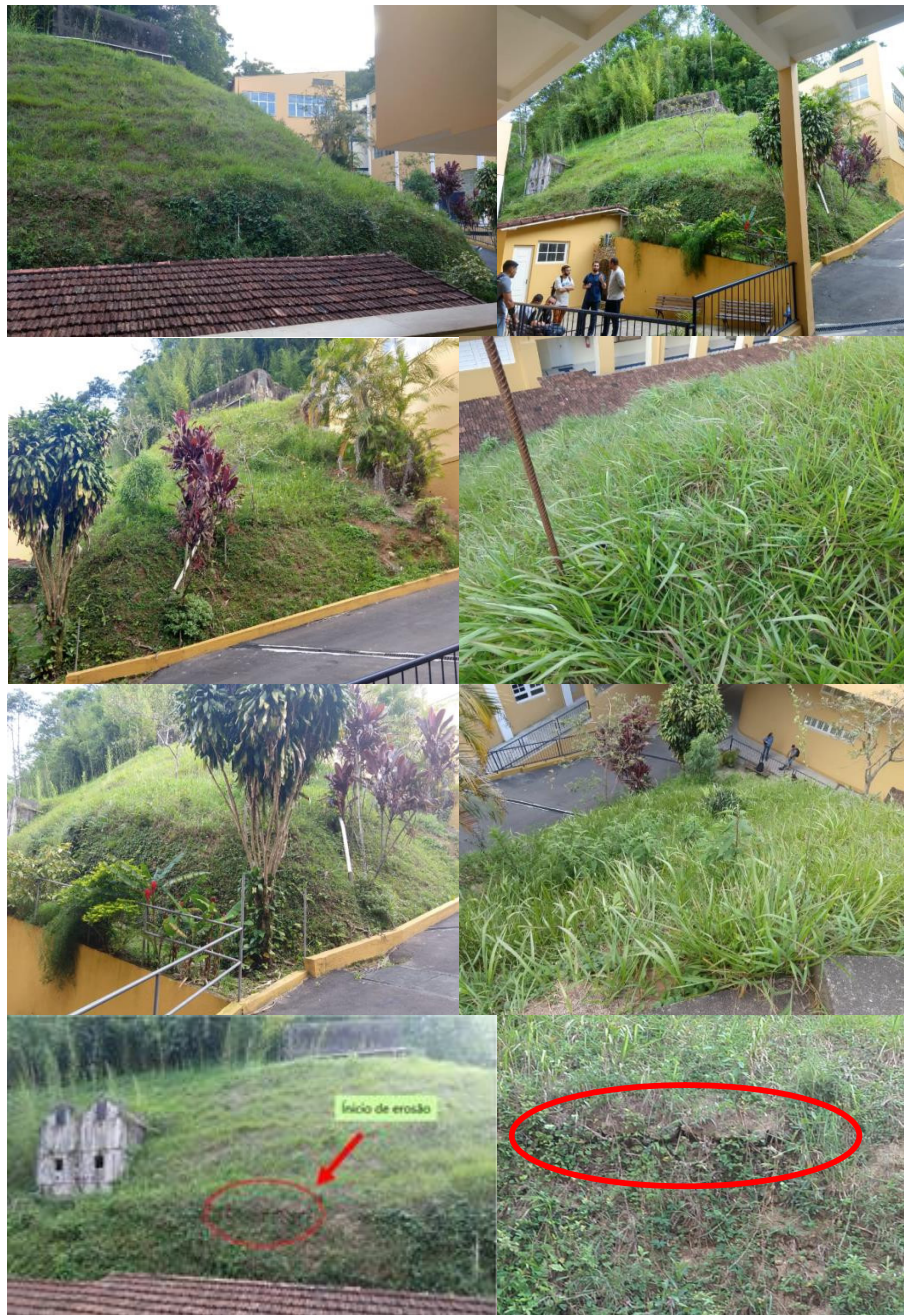
Figura 1: Talude nos fundos da Universidade Católica de Petrópolis (UCP), de vários ângulos, com visualização do início de uma erosão
