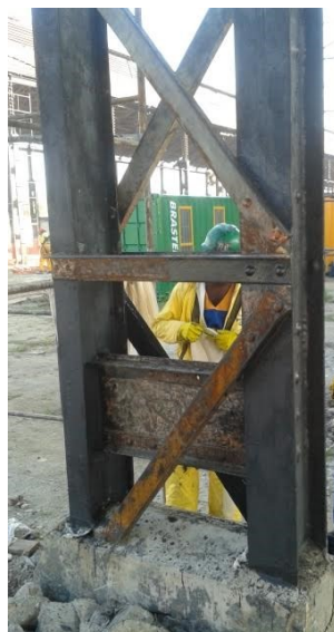
Figura 2: Preparação de superfície, apenas com presença de ferrugem aderida
